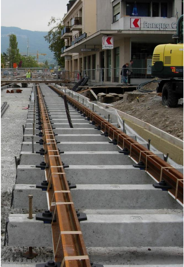
LIGNE 15 – Place du 1 er Août (traverses monoblocs)
